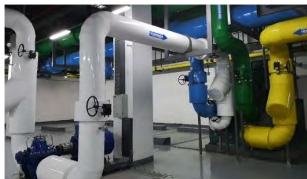
图 19 郴州市东江湖大数据产业园采用冷水制冷
